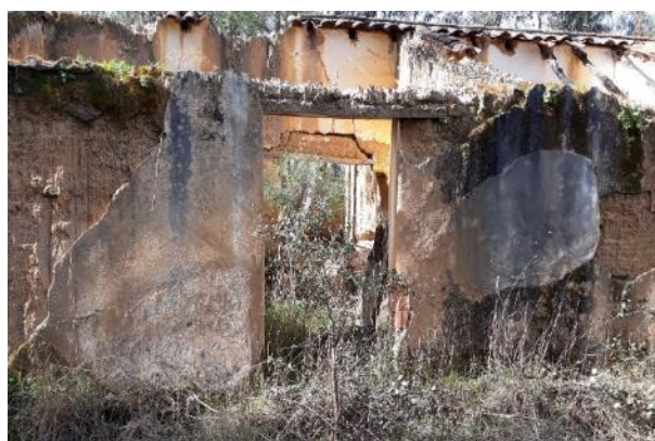
Fotografia 5.18 – Edifícios em ruína.
