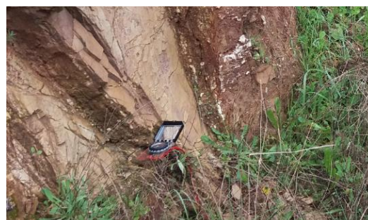
Pormenor do afloramento. Observa-se acentuada alteração da rocha, que se desfaz ao contacto
