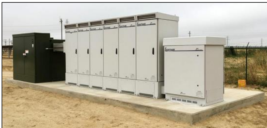
Figura 4.4 – Imagem exemplificativa de uma PVBOX (Inversor e Posto de Transformação) sobre plataforma.
