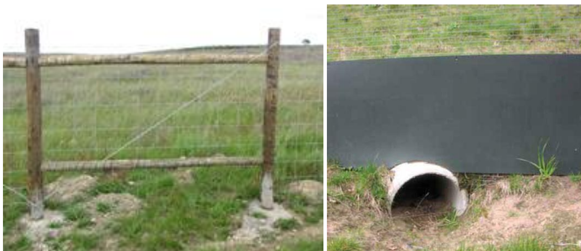
Fotografia 7.2– Passagens para fauna: interrupções na parte inferior da vedação e manilhas.
