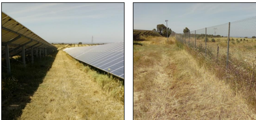
Fotografia 4.6 e Fotografia 4.7 – Exemplo de caminhos entre fileiras de mesas de módulos fotovoltaicos e junto à vedação.
