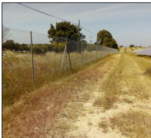
Fotografia 4.12 - Exemplo de aceiro perimetral não compactado, na fase de exploração.
