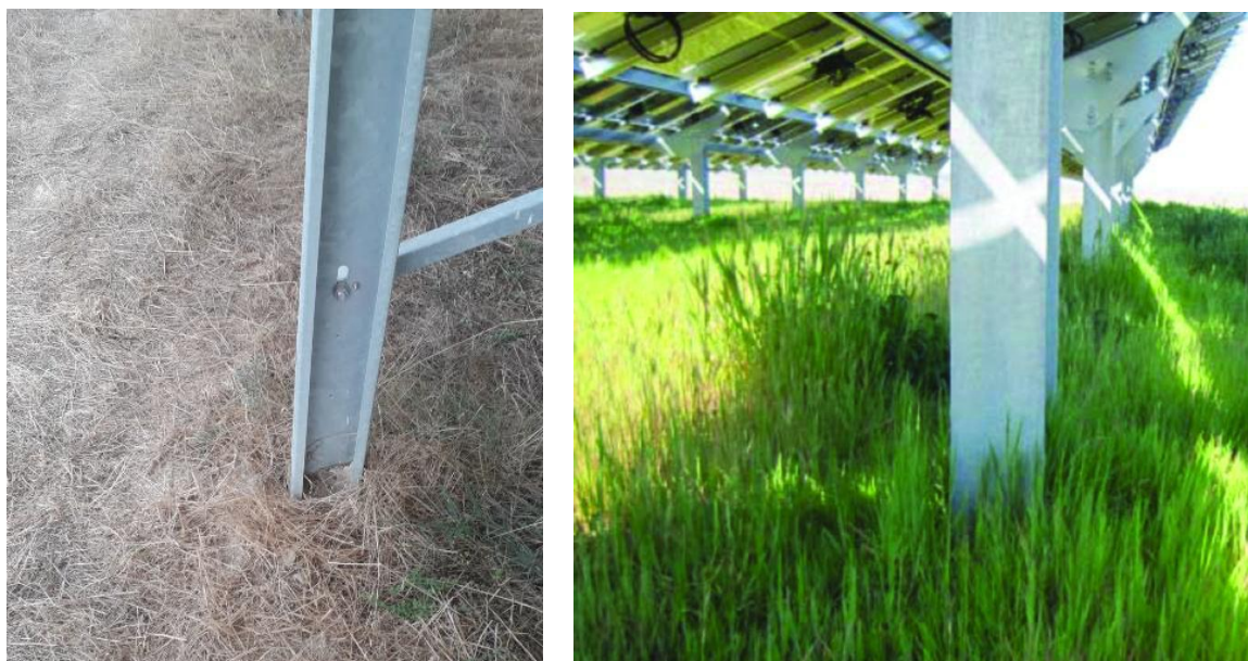
Figura 4.16 – Exemplos de relação de estacas de estrutura de suporte com solo e vegetação.
